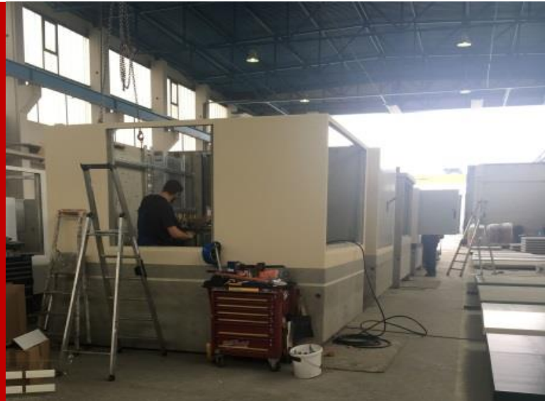
Trafohäuschen verschiedener Ausführungen, Foto: IG BAU
